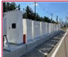
蓄電池システム
