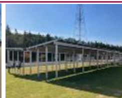
カーポート型 太陽光パネル
